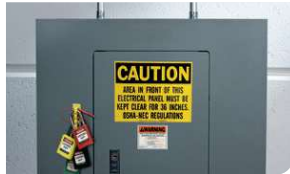
Schalttafel- und Gehäusekennzeichnung
